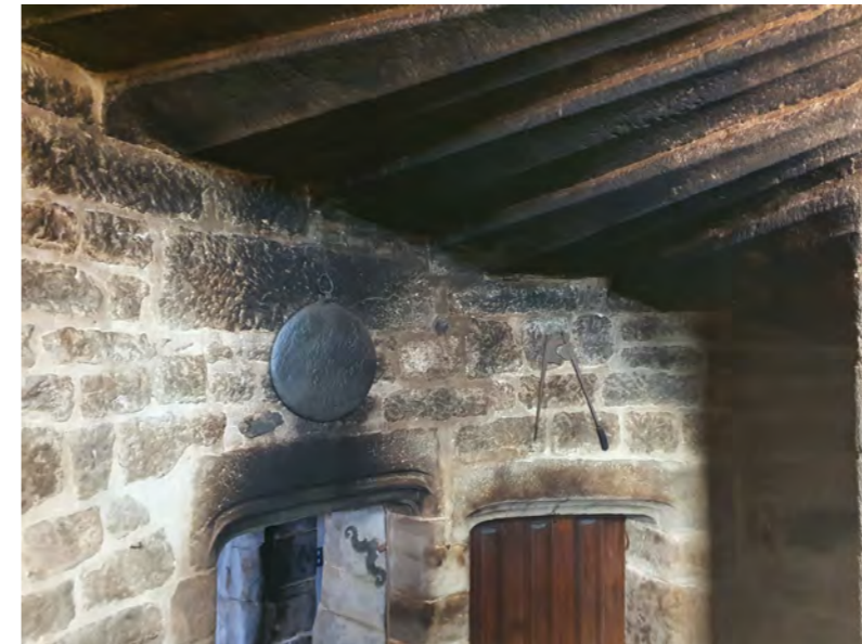
Photo 1: Niveau R+1 : partie de la Tour la plus touchée par l'incendie
